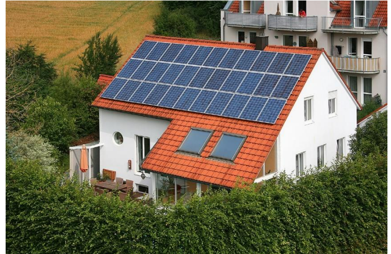
Photovoltaik Anlage auf Einfamilienhaus
